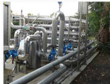
Échangeur de chaleur - CAGNES
