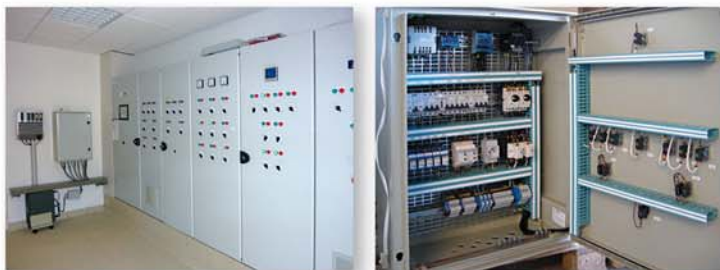
Station d'épuration de LE VAL
