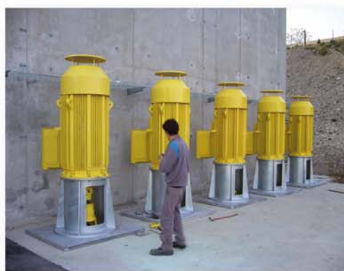
Pompage eau pluviale 6m3/s - AVIGNON
